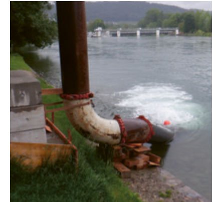
Grundwasser von der Baustelle beim Bahnhof Dietikon wird in die Limmat zurückgegeben
