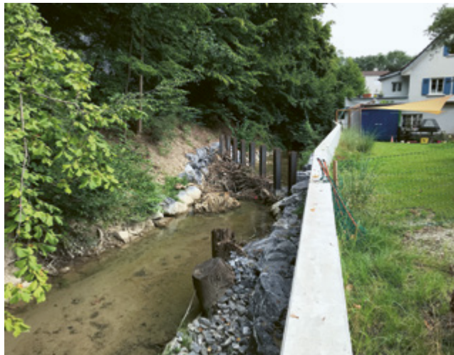
Der Hochwasserschutzrechen beim Schäflibach in Urdorf
