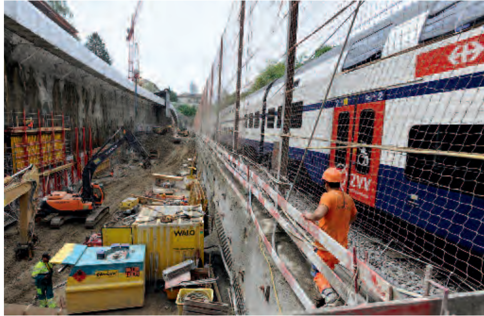
Bauarbeiten im Einschnitt Oerlikon. Direkt daneben fahren die Züge vorbei (oben). Die Stützmauer Hofwiesenstrasse im Bauzustand. Im Hintergrund schützt ein Sicherheitsnetz die Arbeiter vor den durchfahrenden Zügen (grosses Bild).
