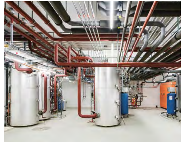
2_ Der Energy Hub im Untergeschoss des NEST.
